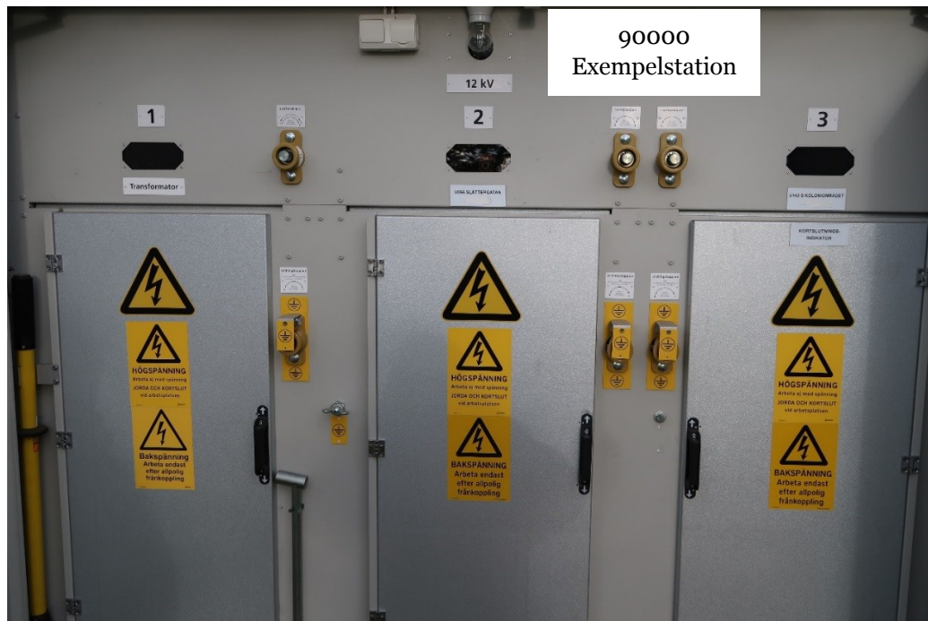
Bild 3 – Luftisolerat ställverk med NAL/NALF. Tidigare märkning av facknummer.
