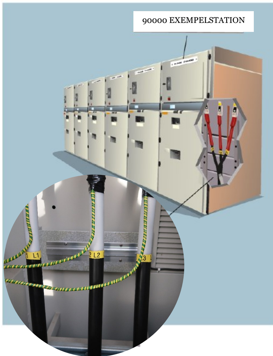
Bild 16. Exempel på märkning av fack samt fasmärkning.
